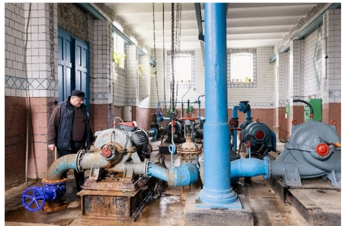
Diese Pumpstation ist bereits seit 1895 in Betrieb.
