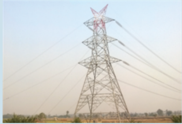
Stromleitungen in Indien. Um Engpässen im Netz vorzubeugen, sollen noch viele Tausend Kilometer folgen. Quelle: KfW Bankengruppe, Urheber: Walter Klotz.
