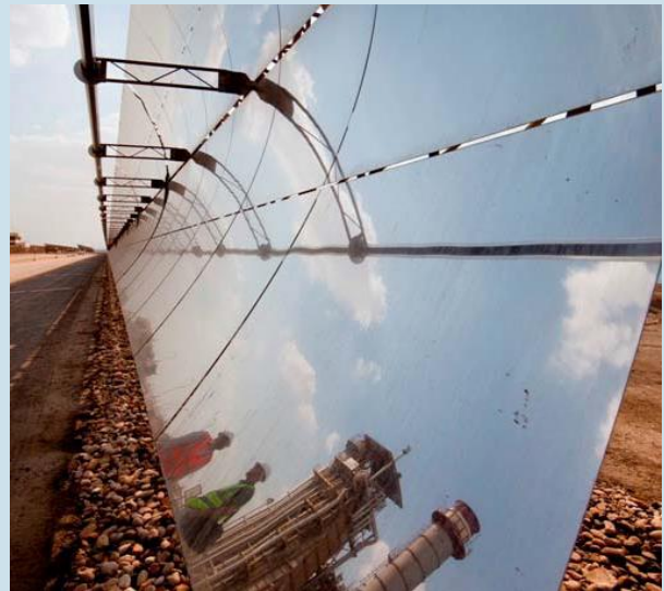
Parabolspiegel an der solarthermischen Anlage. Quelle: KfW-Bildarchiv, Urheber: photothek.net
