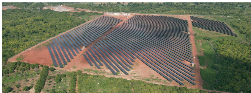
Die Solaranlage in Boundiali gilt als Leuchtturmprojekt in Westafrika und fördert die ambitionierten Klimaziele Côte d'Ivoires.
