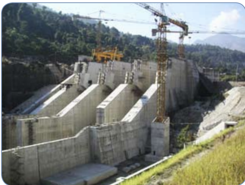
Der obere Teil des Wasserkraftwerks Middle Marsyangdi.
