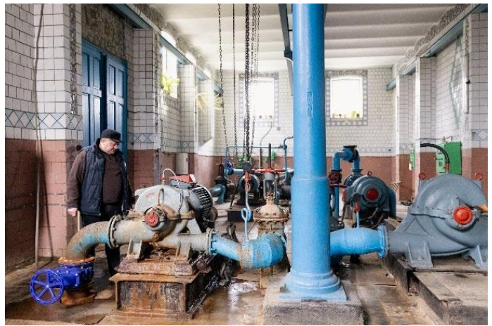
Diese Pumpstation ist bereits seit 1895 in Betrieb. Quelle: KfW-Bildarchiv / Jonas Wresch
